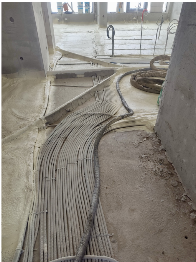
Участок в процессе работ: открытые кабельные трассы и локальные дефекты бетона.
